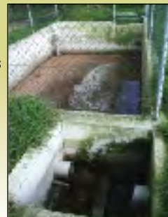
● UN REGARD RÉPARTITEUR 80 % de l'effluent traité sont redirigés dans le bassin tampon de sédimentation en traitement primaire. 20 % partent en traitement tertiaire dans le verger.
