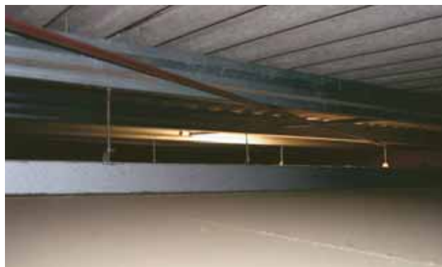
Vue intérieure du capteur solaire (installation de M. Marre, Caussade 82)
